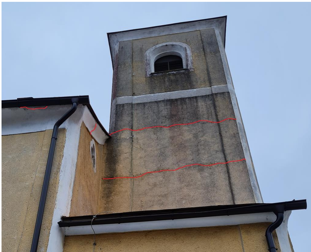
Slika 18. Blago konstrukcijsko oštećenje
