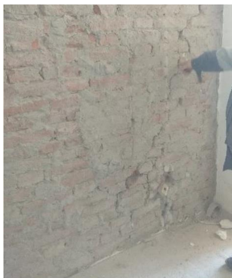
Pukotine širine veće od 10 mm
