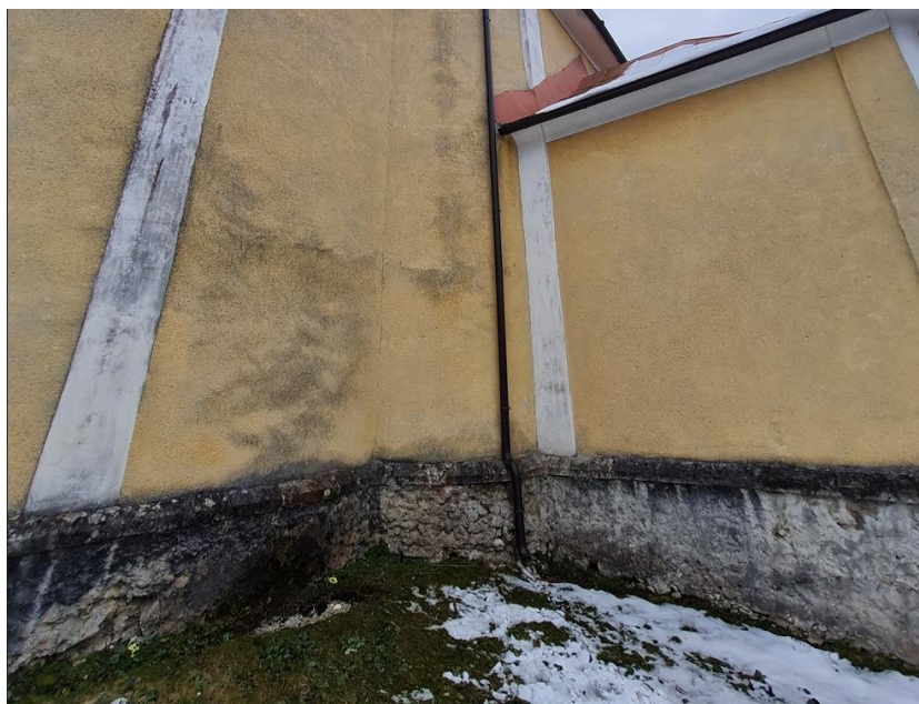
Slika 19. Blago konstrukcijsko oštećenje
